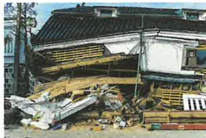
地震による被害例 (能登半島地震)
